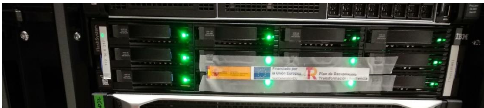
Cabina disco rotacional IBM CPD Secundario
