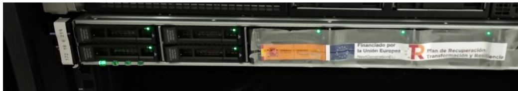
Cabina All-Flash IBM CPD Secundario
