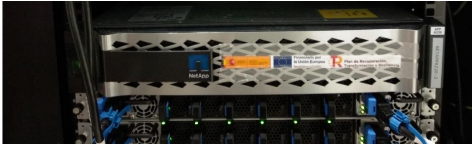
Cabina All-Flash Netapp CPD Secundario:
