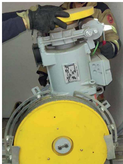
Maniobra Manual de Emergencia con sala de máquinas
