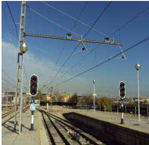
Catenaria Ferroviaria Convencional
