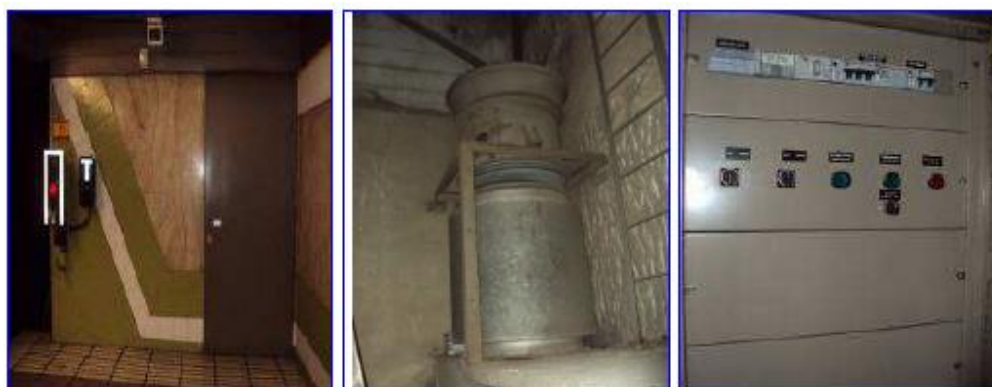
Sistema VEA en estación Líneas 1 y 2 y Gabinete de Circulación
