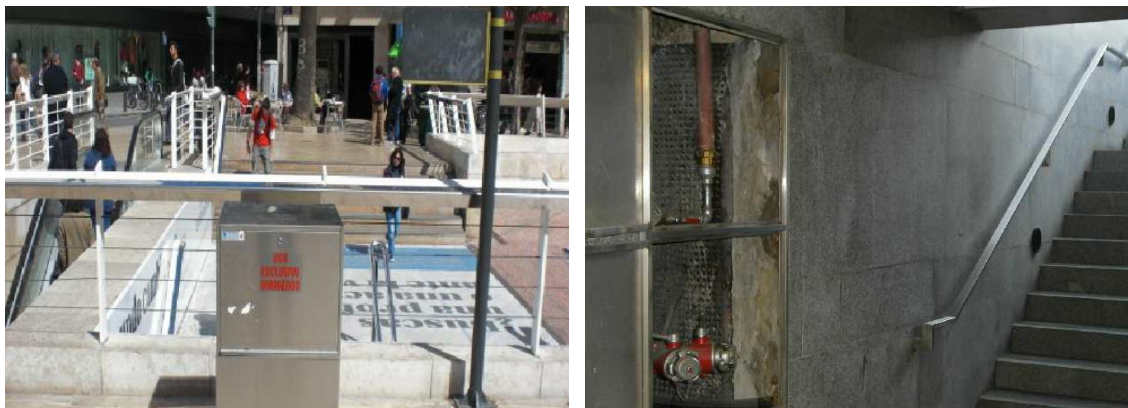
Tomas de alimentación de Columna Seca
