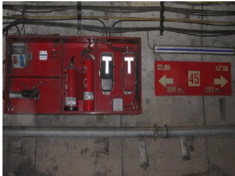
Armario de emergencia con toma salida de columna seca
